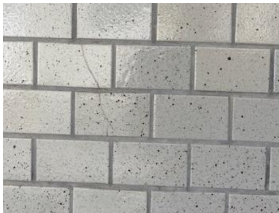
図1 経年劣化でひび割れが生じたタイル
